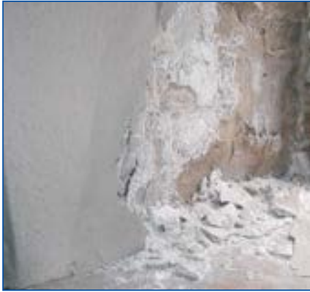
1 Mokry, zasolony i zawilgocony mur.
