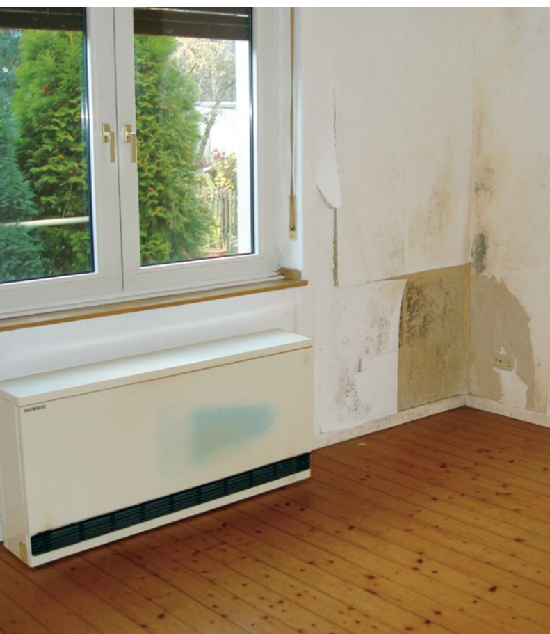
Typowy obraz szkód spowodowanych występowaniem mostków cieplnych i brakiem cyrkulacji powietrza
